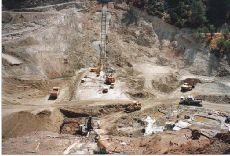
Γενική άποψη θεμελίων του φράγματος - General view of the foundations of the dam
