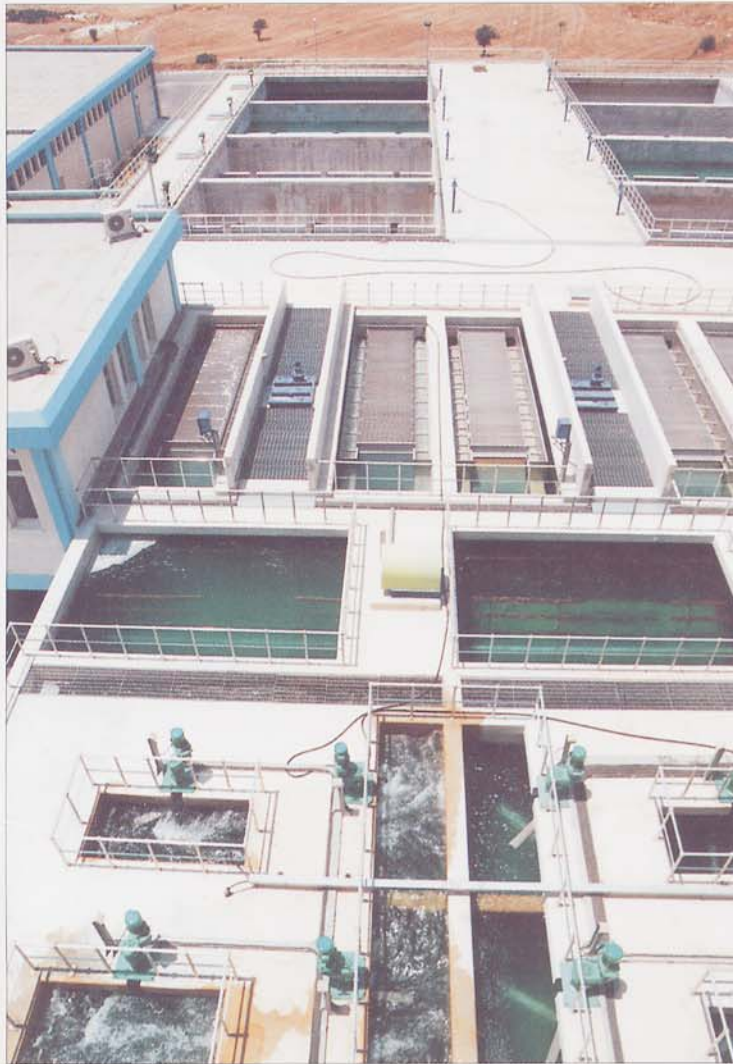
Δεξαμενές επεξεργασίας νερού - Process line structures
